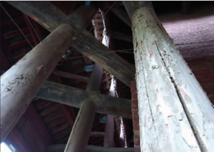
脱落的建筑彩绘
