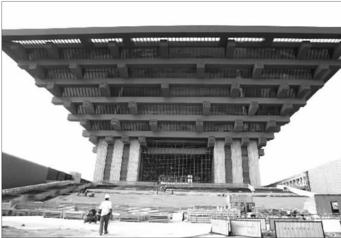
中国2010年上海世博会中国馆正在加紧施工中,工程预计将于2009年年底全部竣工。图为建设中的2010年上海世博会中国馆。 新华社记者 刘颖摄
