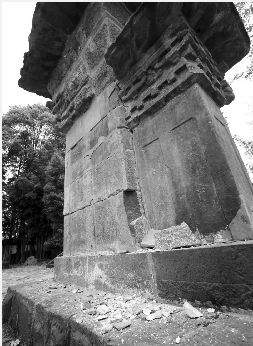
四川芦山县沐东乡黎明村的汉代建筑遗址樊毅阁及石刻是全国重点文物保护单位,地震发生后,阁檐下的石刻面出现裂纹,阙身部分已经掉落。
